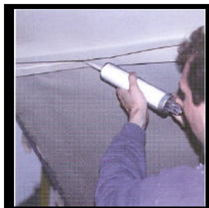
Abb. 12: Verdeckte Leckagen werden gefunden und beseitigt mit Dichtmitteln oder Dichtklebeband
