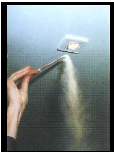
Abb. 11: Leckagen suchen – einströmende Luft wird mit freigesetztem Rauch sichtbar gemacht
